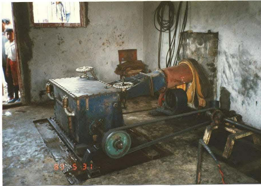
既存極小水力発電クロスフロータイプ (25kw) PENANGGAL村 CANDIPURA郡
