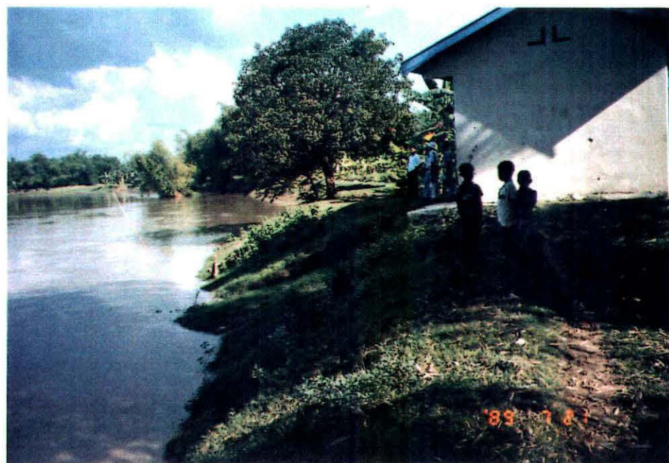
← (左) ②稼動可能な公共機場 (のりの一部が崩れ始めている)
