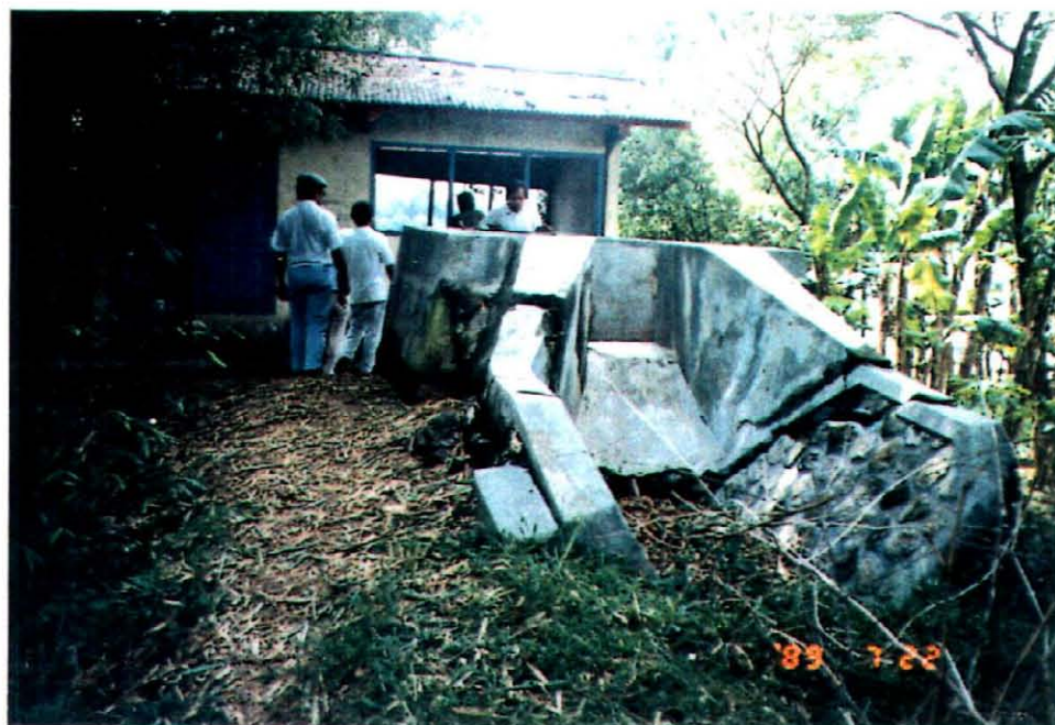
⑨沈下激しく使用不能の 公共機場
