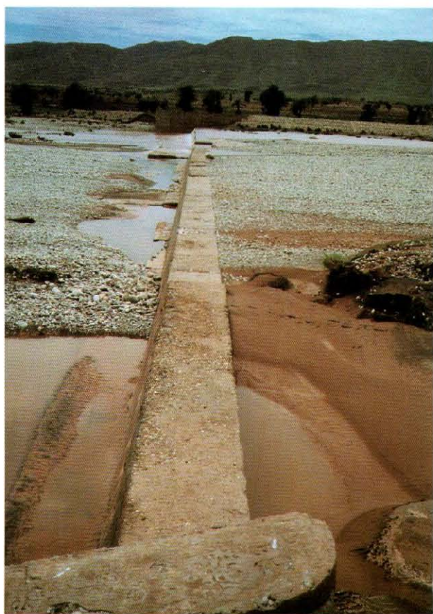
Sharki Dam 下流部既存 頭首工 (完全にシルトアップしている)
