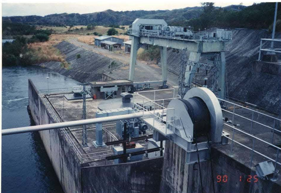
写真4 MASIWAY ダム洪水吐ゲート 操作設備
