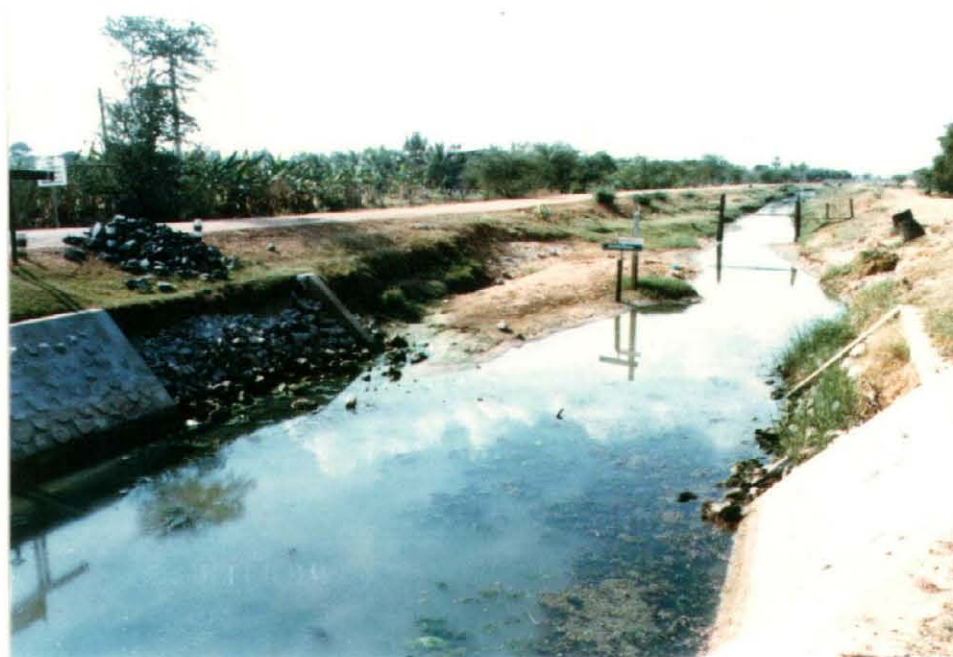
改修を要する支線水路（L-4）
