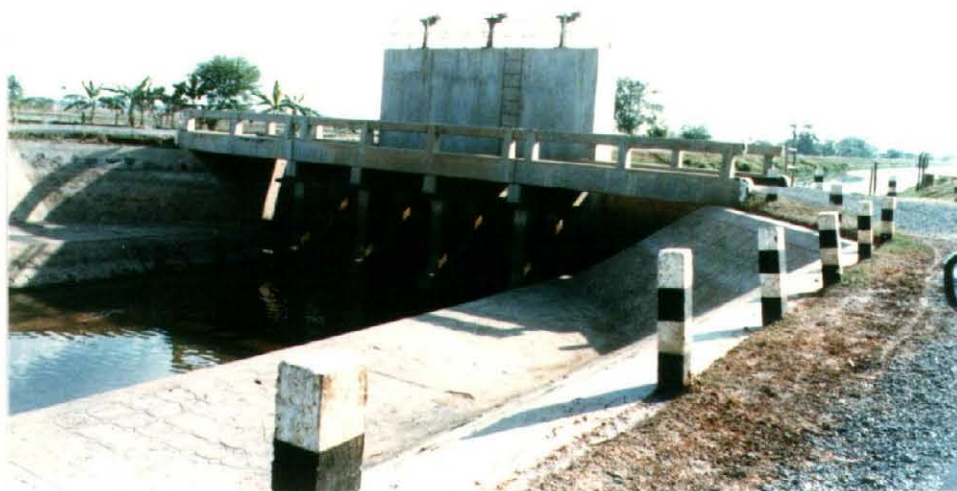
幹線水路のチェックゲート
