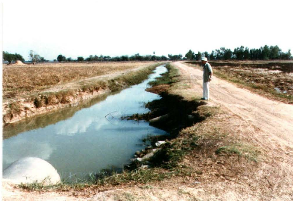
改修を要する支線水路 (L-5)
