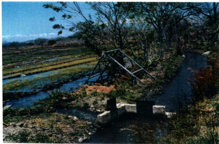
(3) 南部、カーニャス地区 直接分水（コンクリート管とスライドゲート） により導水された第3次支線 水稲直播 （2月）
