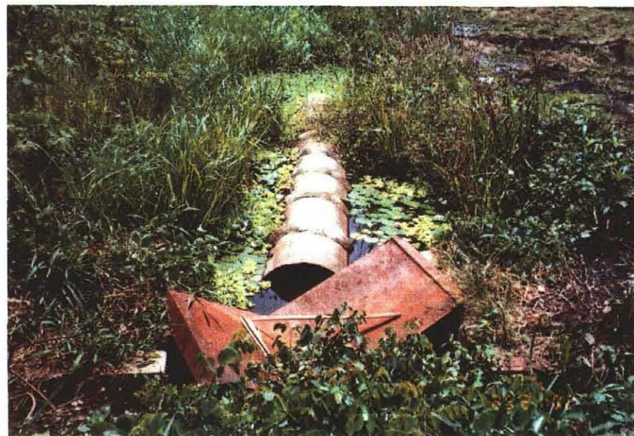
壊れたゲート
