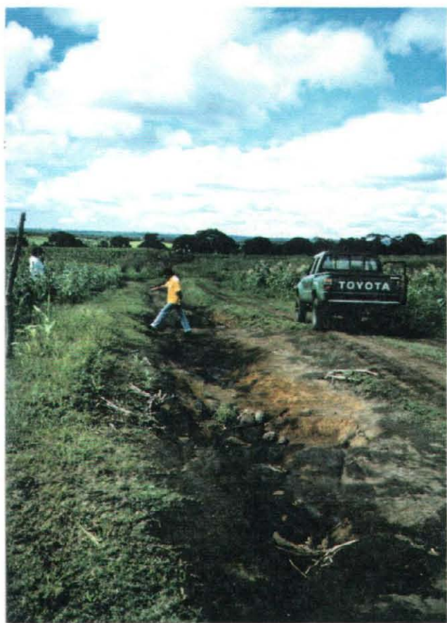
乾期における道路の陥没状況
