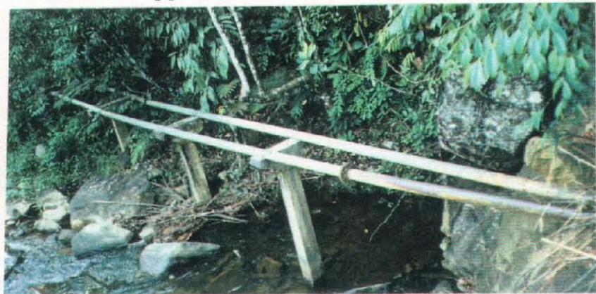
湧水からの生活用水供給パイプライン Water supply pipe-lines from spring
