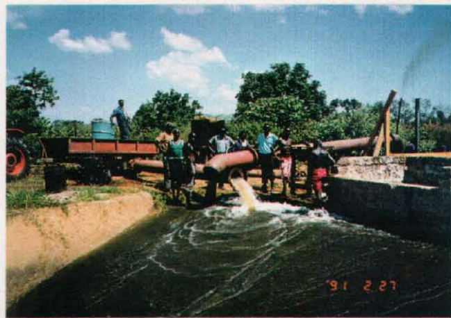
⑦ ブニャラかんがい計画のかんがい用ポンプ故障が多く、 応急処理で運転中
