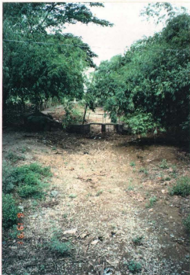
1991年5月 ディパロRIS 主要幹線水路 洗掘され修復の必要がある。
