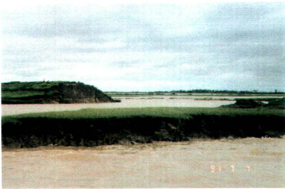
河川堤防 破堤
