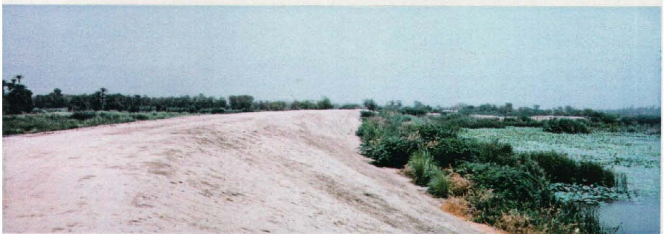
④ 大洪水時、堰 (Barrage) の保護のため人工的に破壊させている堤防
