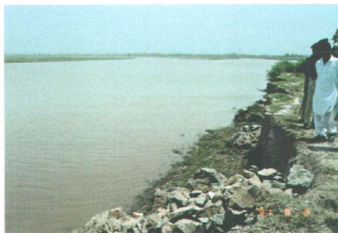
⑫ 侵食状況
