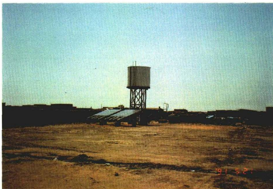
太陽光利用給水施設、1990年設置 (カルツーム近郊)
