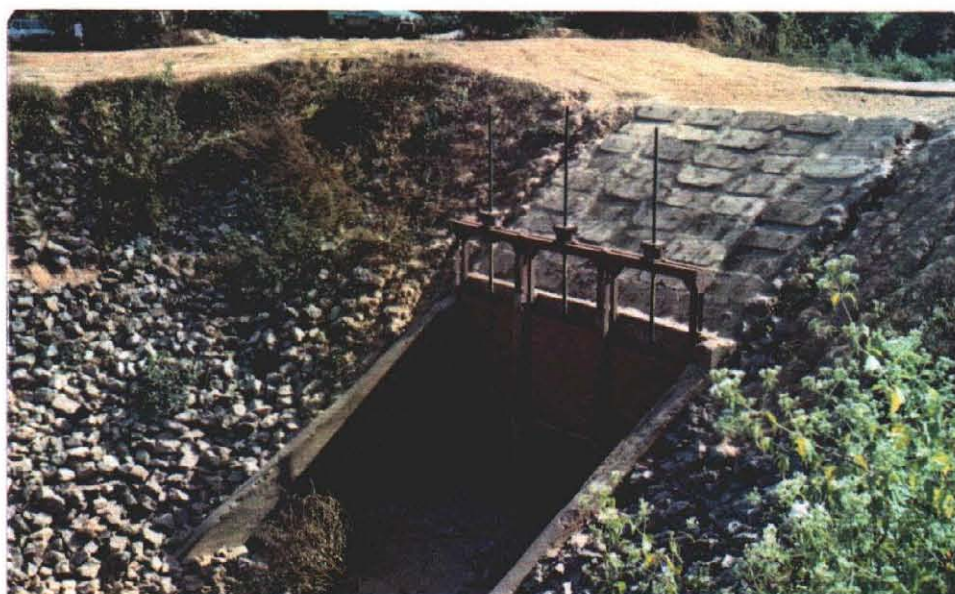
パプン地区 小規模な逆流防止水門
