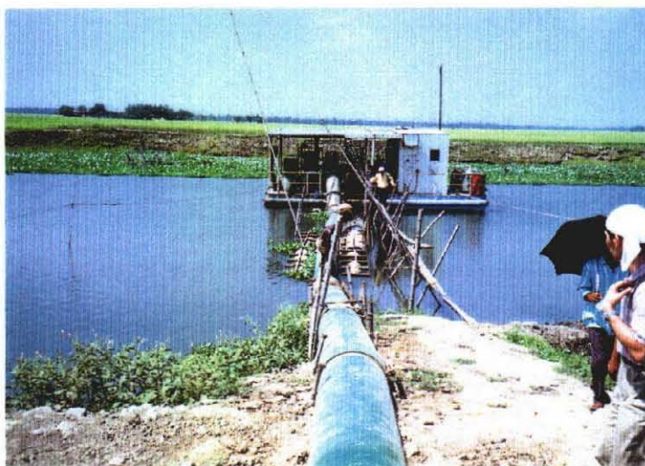
Shahrasti Upazila のNoringbill Scheme 配管状況
