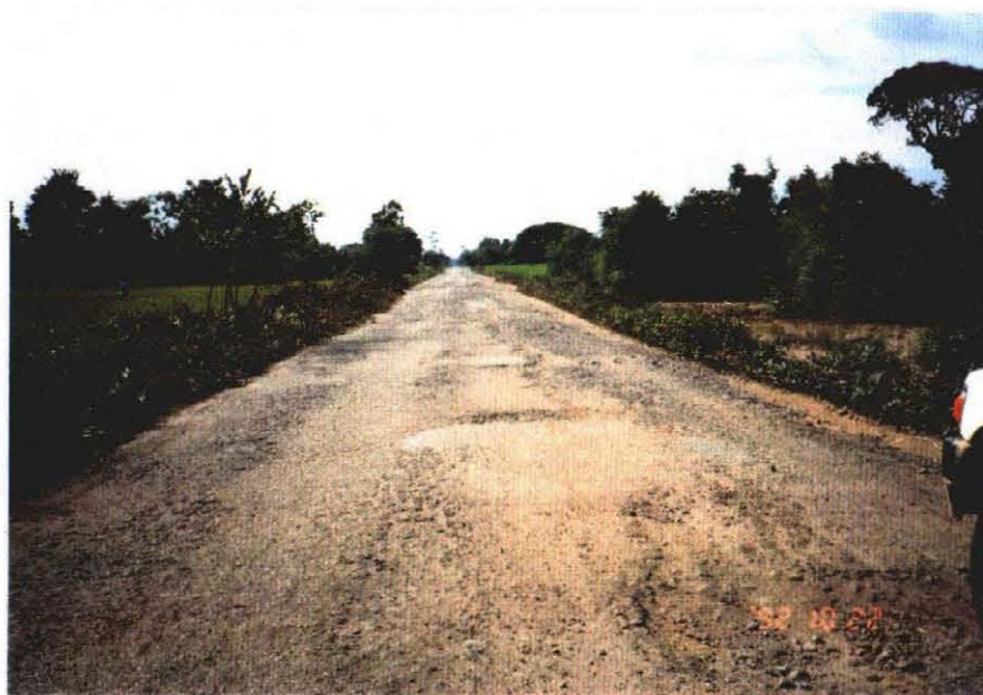
舗装の損傷が著しいパリン地区内の国道10号線
