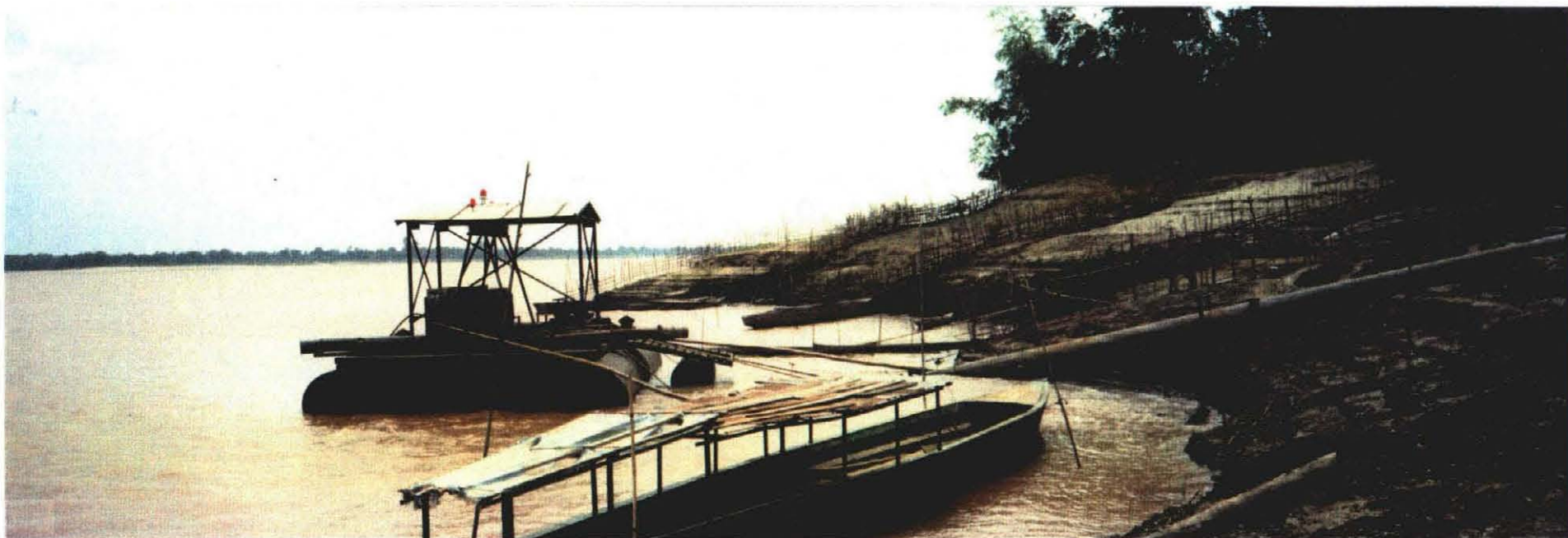
チャムバサック地区内の既設フローティングポンプ
