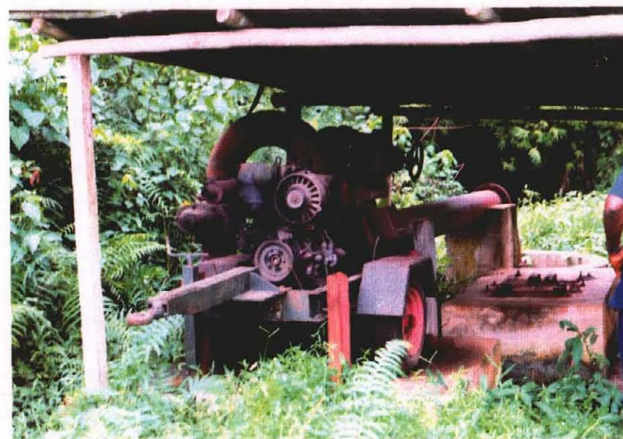
STATION DU POMPAGE
