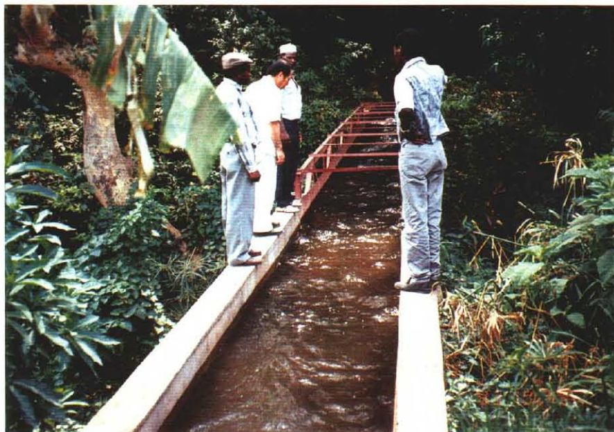
既存灌漑事業地区内の 幹線用水路の状況。
