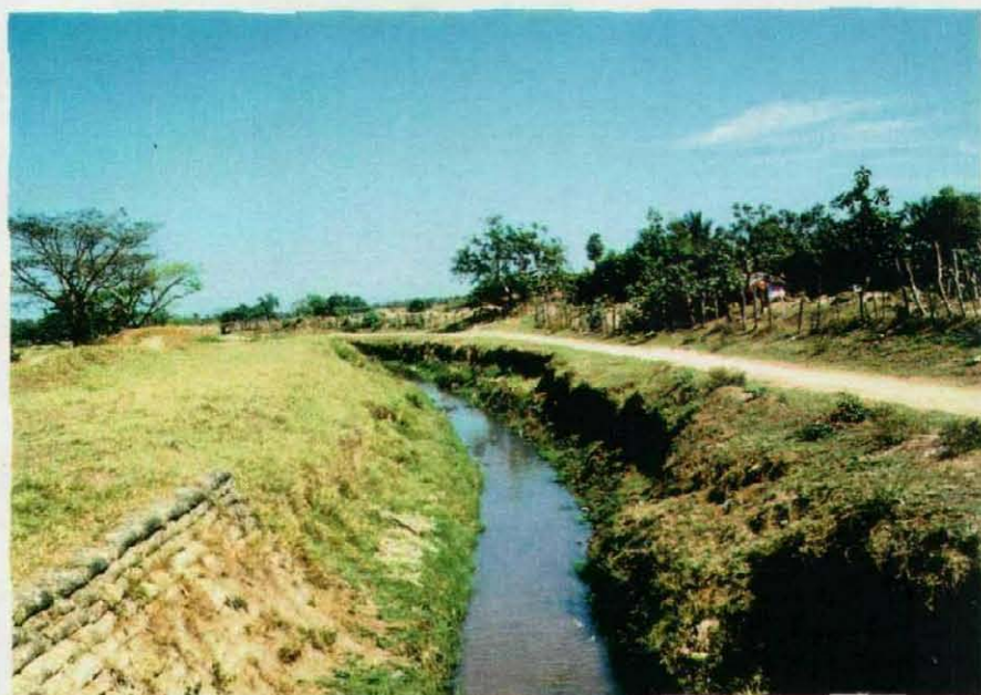
ラ・ビヒア水路の上流 ライニングする必要がある。
