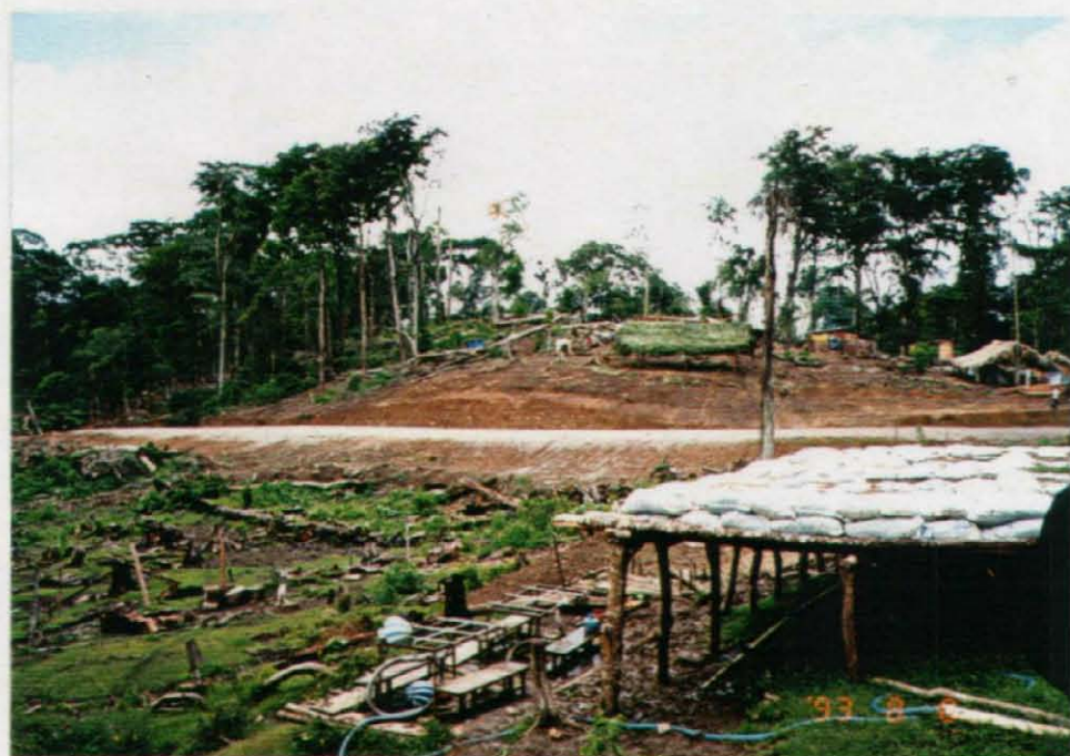
同キャンプの簡易給水設備
