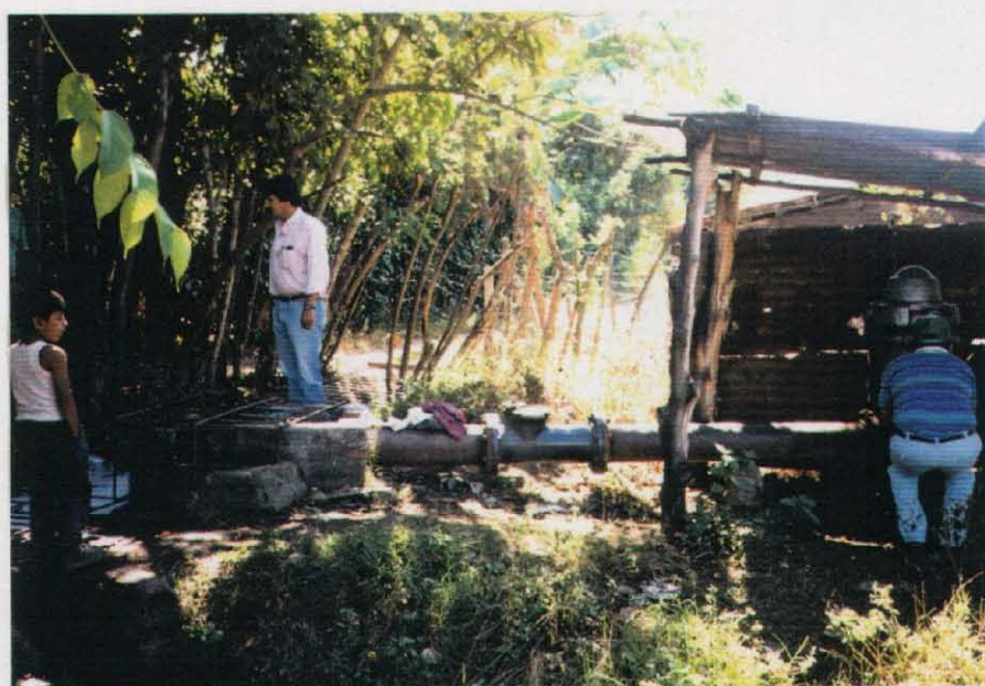
灌漑用の地下水ポンプ場
