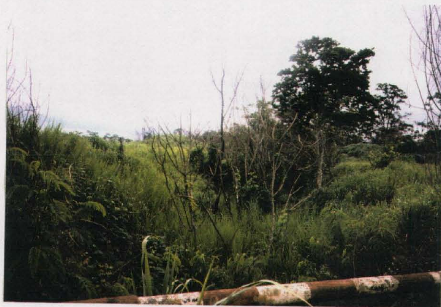
サンファン移住地内の排水路の状況（埋没し雑木が繁茂）
