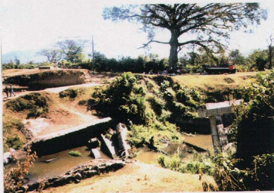
崩壊したまま放置されている橋梁
