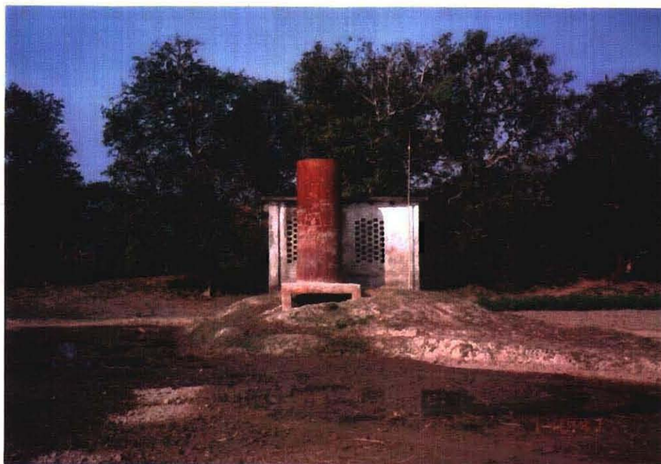
埋設パイプライン（既設のポンプを利用して灌漑水を配水する。Daudkandi 地区）
