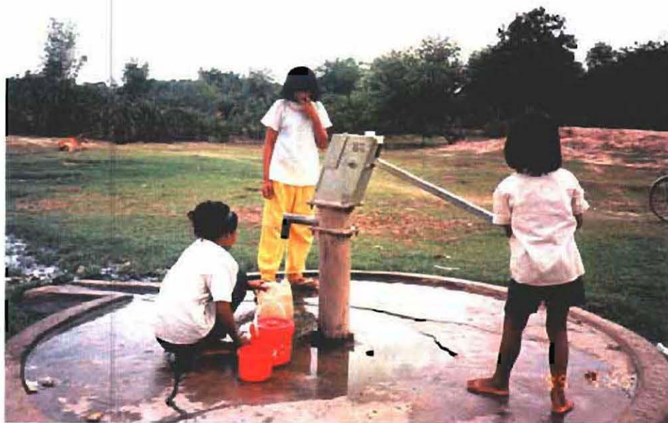
UNICEFが建設 した農村給水 施設 (ハント'ホ'ンブ') サハ'イリエン県
