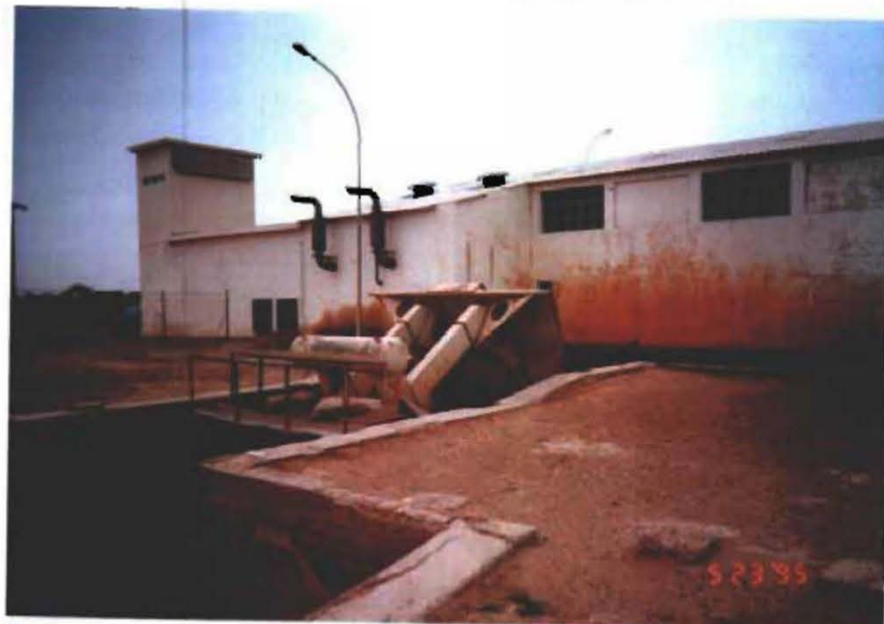
① 地区内のポンプ場 (1977年設)
