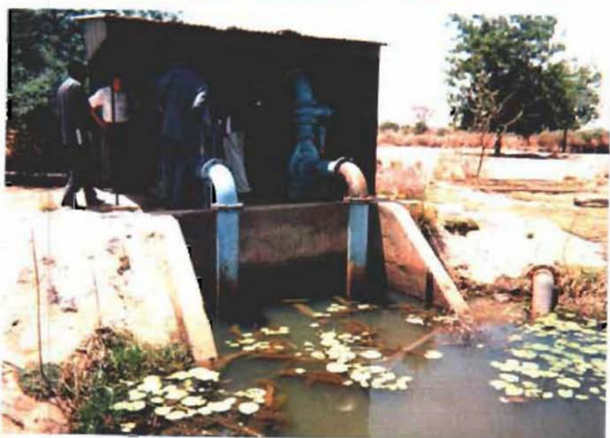
ロサ種子センター 既存ポンプ場
