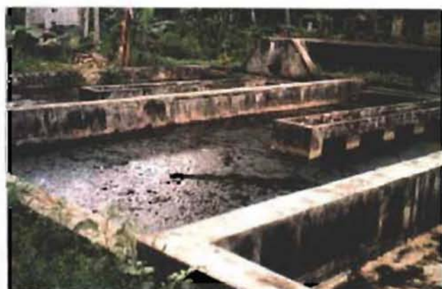
老朽化した汚水処理施設 (アタナガラ中央病院)
