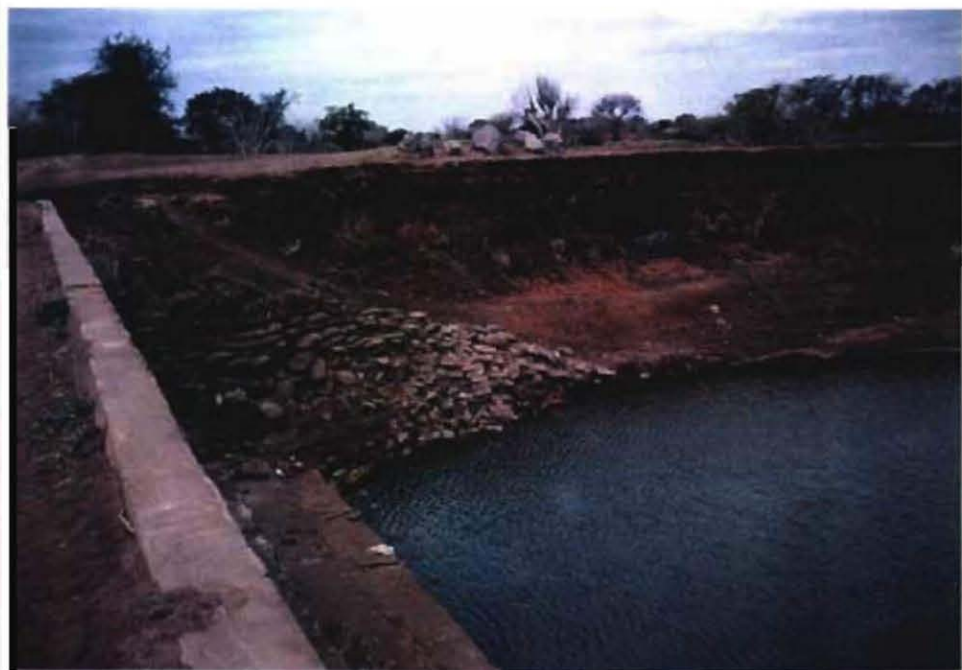
幹線水路（法面の侵食が著しい。）
