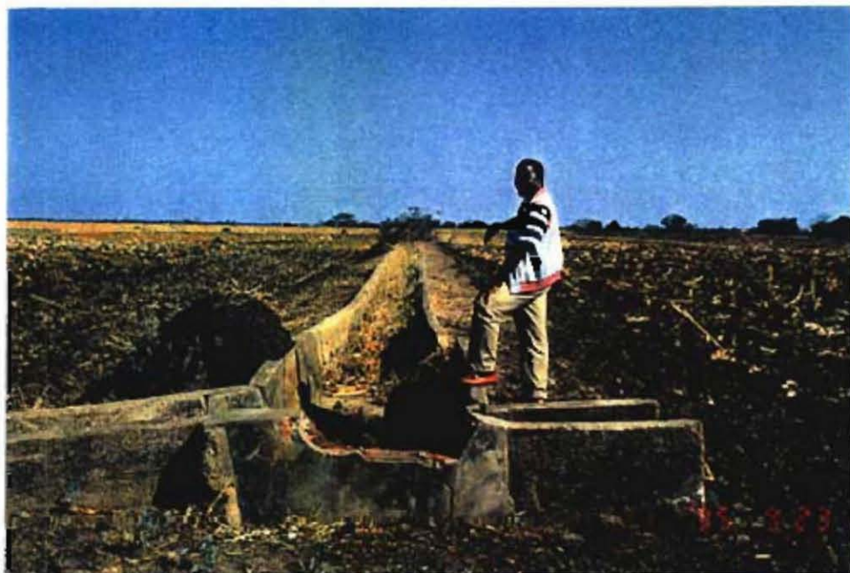
崩壊した水路。ポンプがない為、乾期の栽培ができない。
