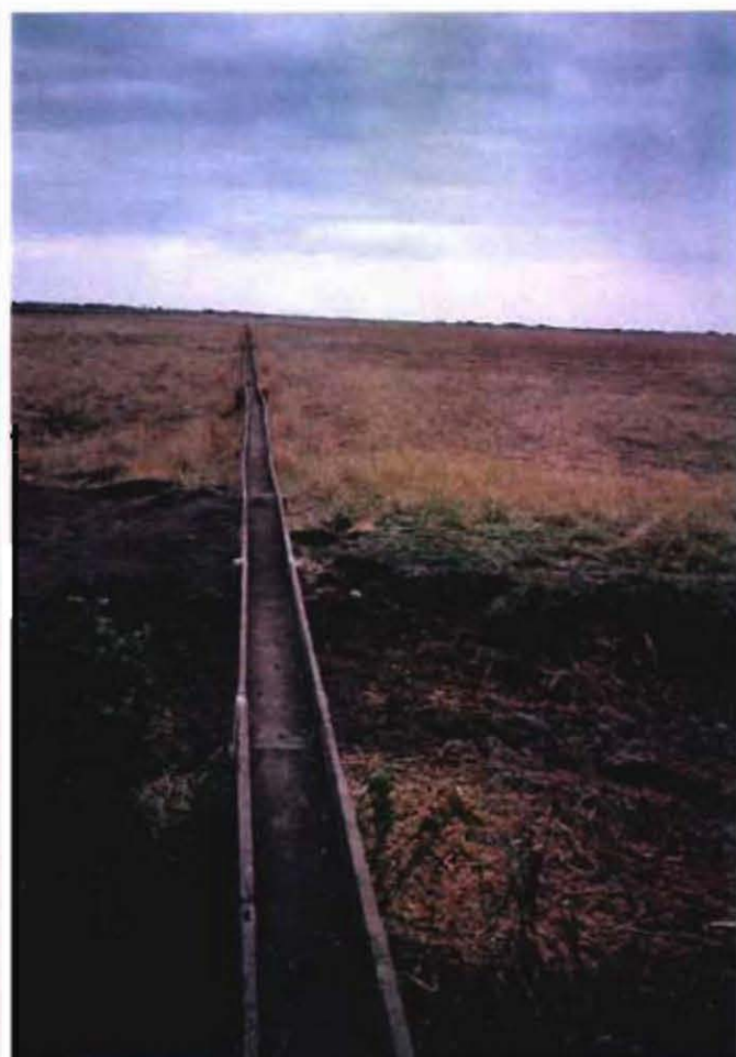
コンクリート水路 (老朽化により水漏れが著しい。)
