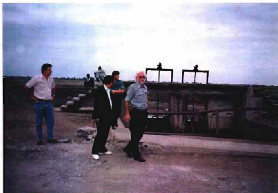
幹線水路分水口（ゲートは錆び付いており操作不可能。）
