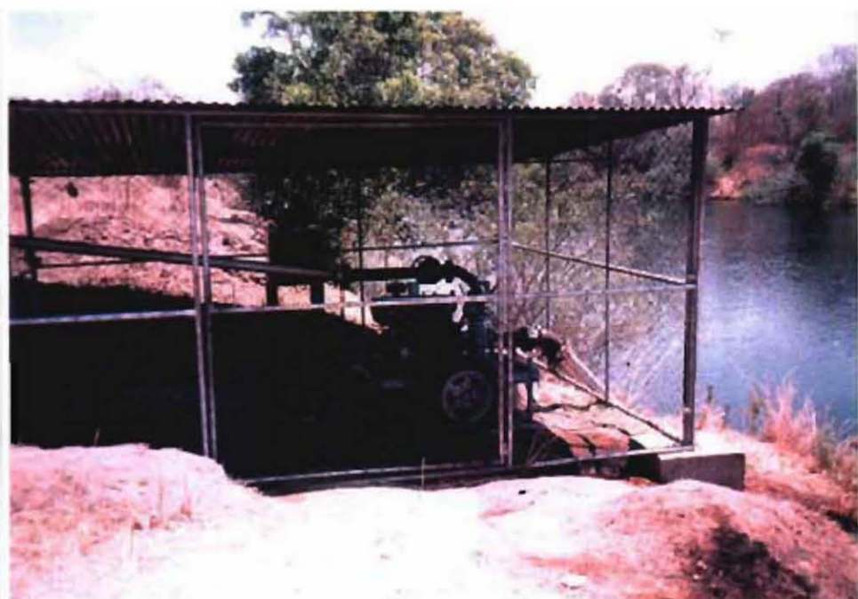
ヒュンヤニ 4 川の既設のポンプ（φ 150mm）。移動式で病院に給水している。
