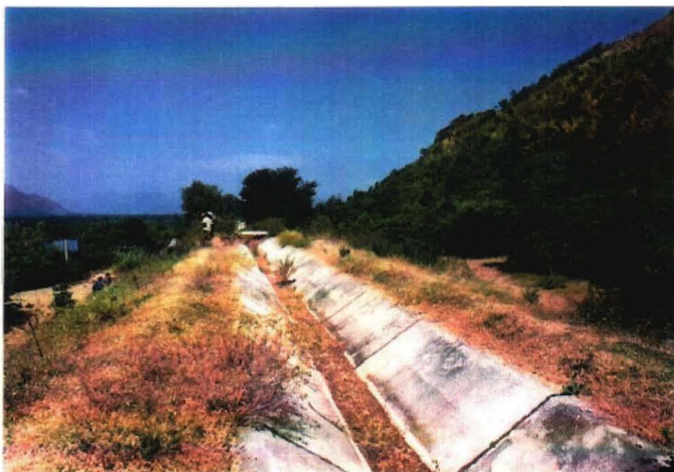
WANDONG地区へKuwai Yai川からポンプで揚水し、送水しているコンクリートライニング水路。DEDPが建設したが、残り1.0kmが未施工のため送水をした事がない。水路は盛土である。
