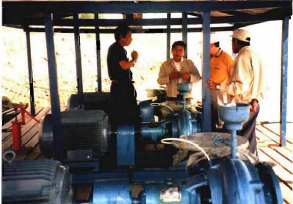
既設の フローティング ポンプ場
