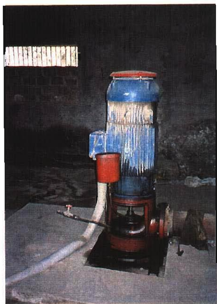
電動のポンプ設備 (稼働中:イカ地区)
