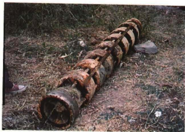
使用不能となったポンプ（ラ・ヤラダ地区）
