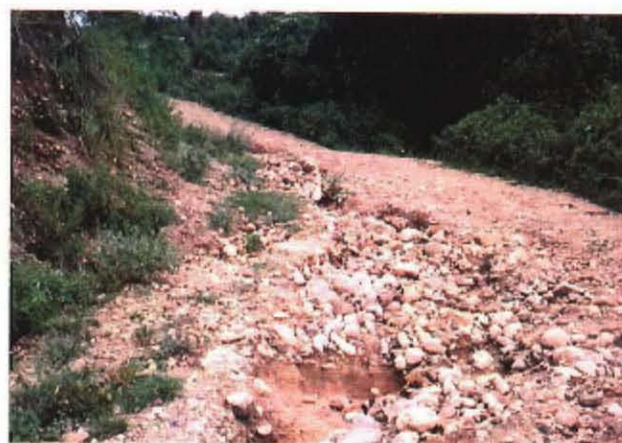
農村道路の状況（雨期の状況）
