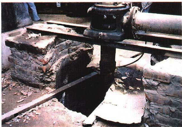
上記写真と接続しているポンプ
