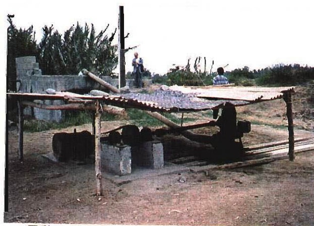
電動のポンプ設備 (稼働中:ラ・ヤラダ地区)
