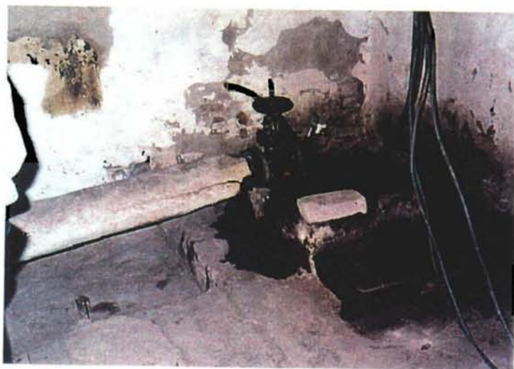
大学給水用既設深井戸ポンプ
