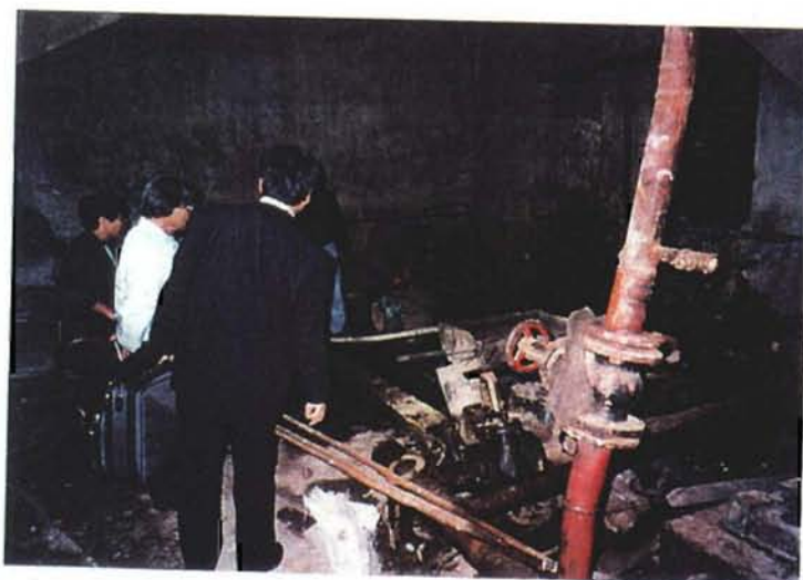
大学給水用既設送水ポンプ
