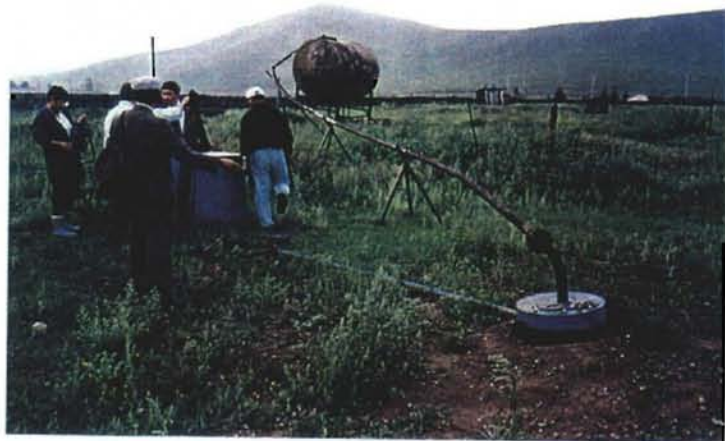
試験栽培用既設揚水ポンプ
