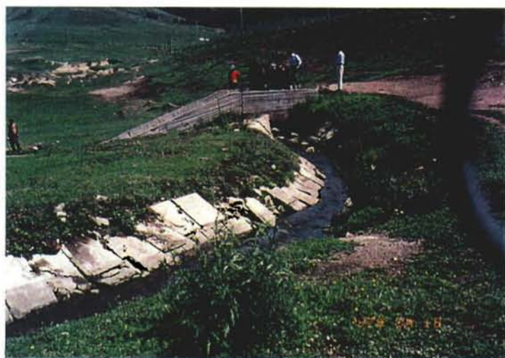
Jargalant 崩壊の著しい左岸幹線水路
