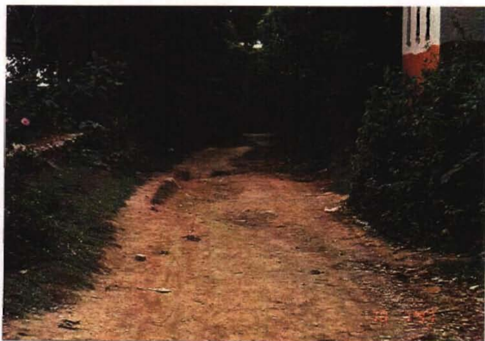
整備不良の村落道路
