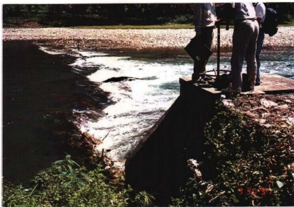
SPINプロジェクトサイトの取水設備 (蛇笕によりせき上げを行っている)
