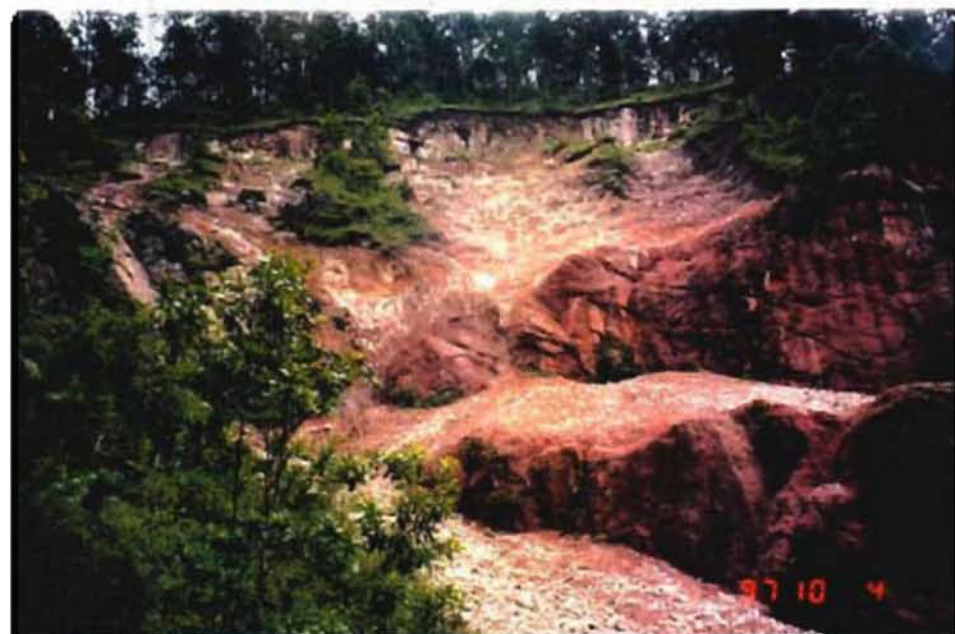
計画対象地内の 山腹崩壊地 伐採するとこのよう な斜面崩壊が発生し やすい
