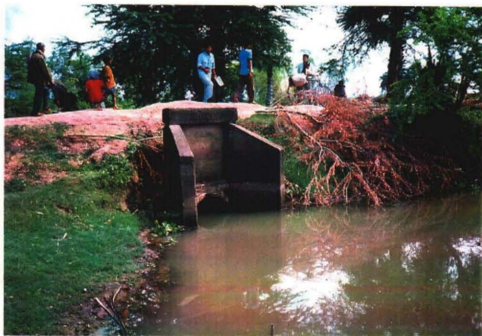
同地区のボルボト水路。破損したままになっているため、余り機能を果たしていないようであった。
