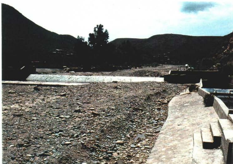
河川からの取水工は土石が埋まって取水効率が低下している風景
