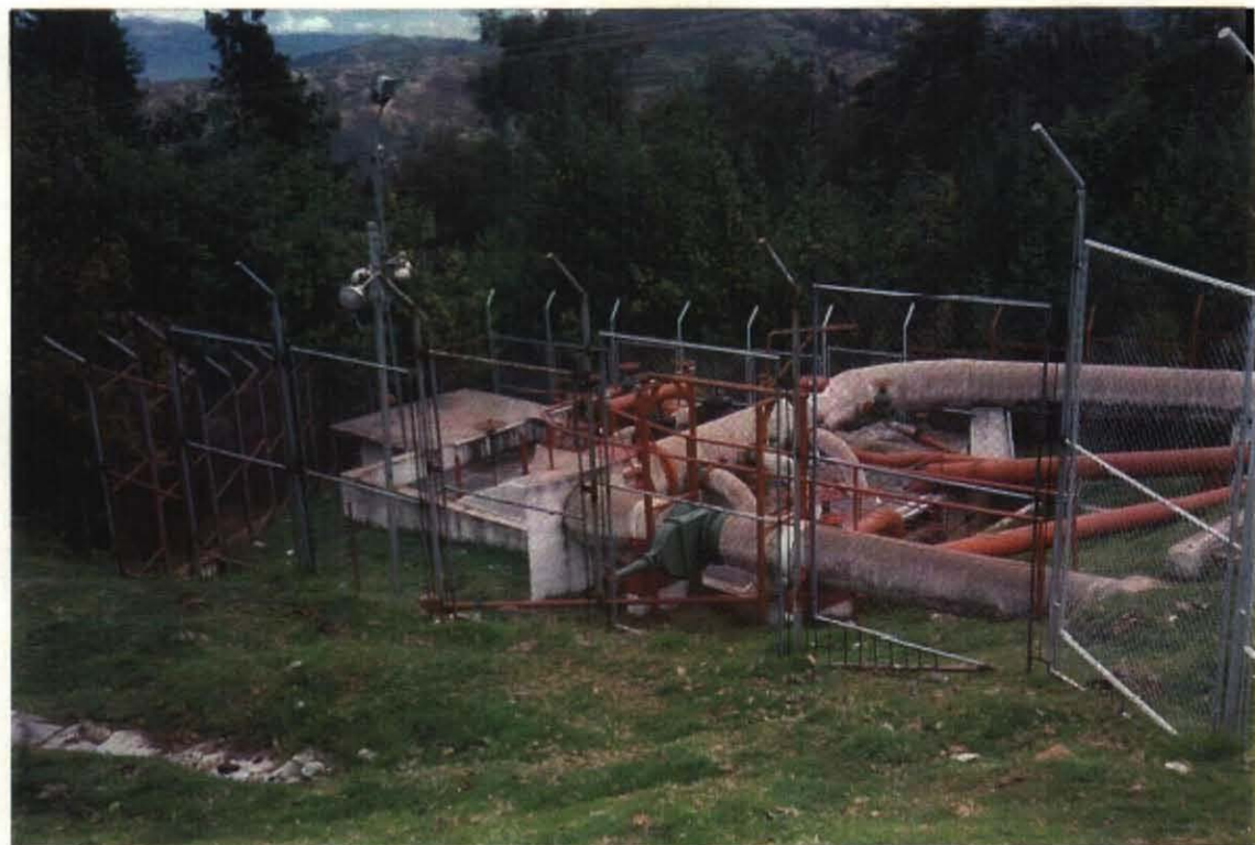
ソガモソ市水道等下流域地域へ供給されている取水施設
