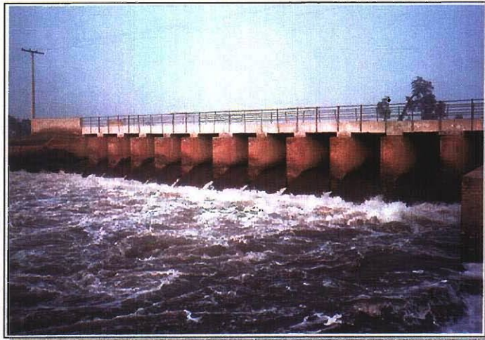
No.8 落差工 水路上流部の落差工で、流量が計画流量より大きく、流速はかなり大きい。
