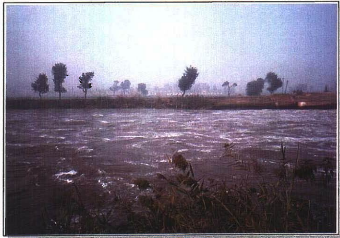
No.14 橋梁下流部 乱流により堤防が大きく侵蝕されており、杭による簡易対策がとられている。
