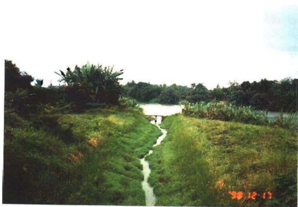
スワダヤ取水工 (著しい土砂の堆積)
