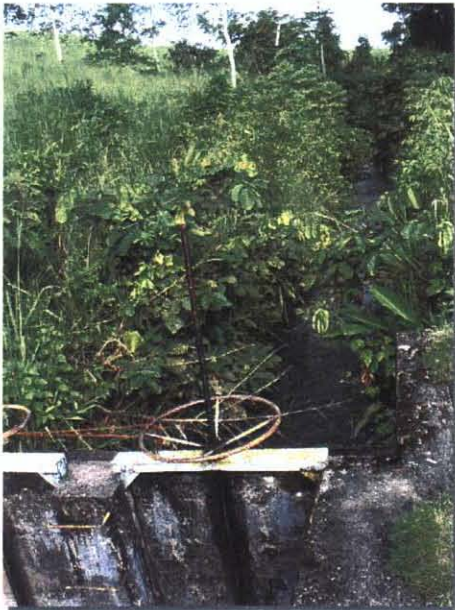
支線用水路へのゲートコントロール部。
