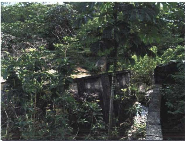
洪水により破壊されたままの取水堰。
