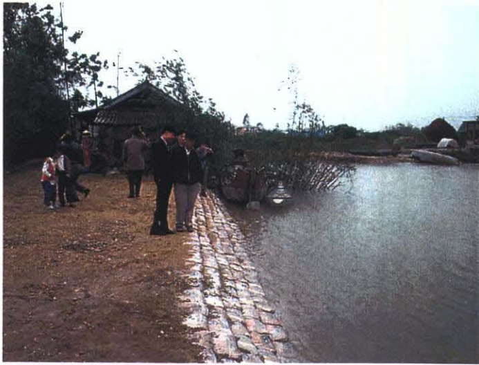
湛水被害により、水路沿いの堤防が削られている。毎年、土嚢を積むことで修理している。
