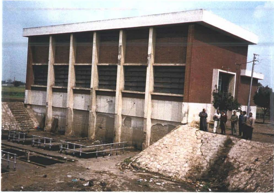
El Gineina 排水機場：吸込み側全景、モルタル化粧の剥離が見られ補修が必要
