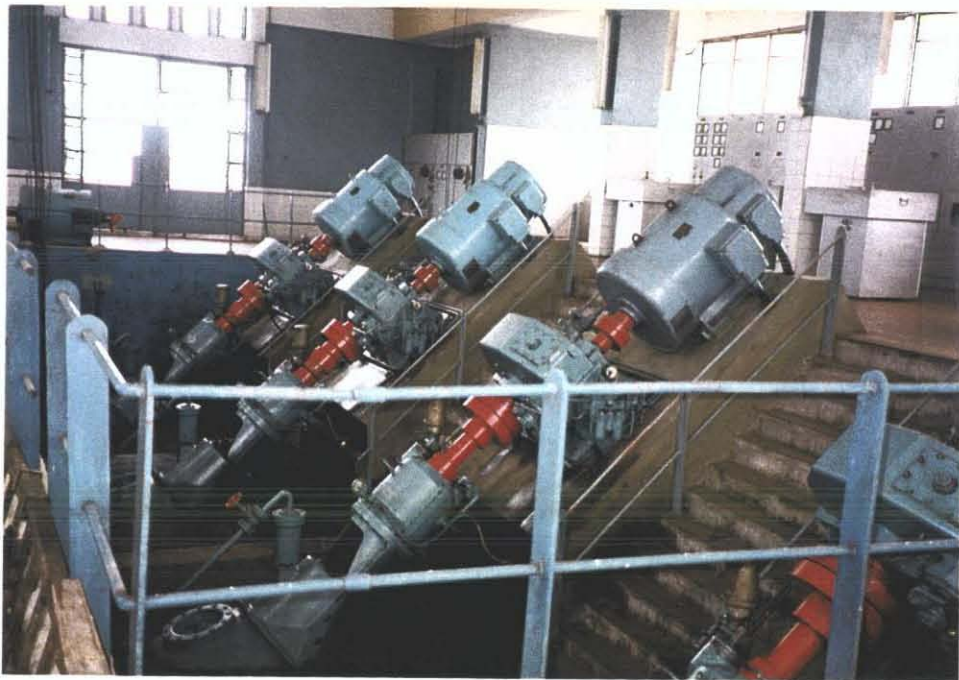
El Sadka 排水機場内部：主要駆体部の老朽化が進んでいる
