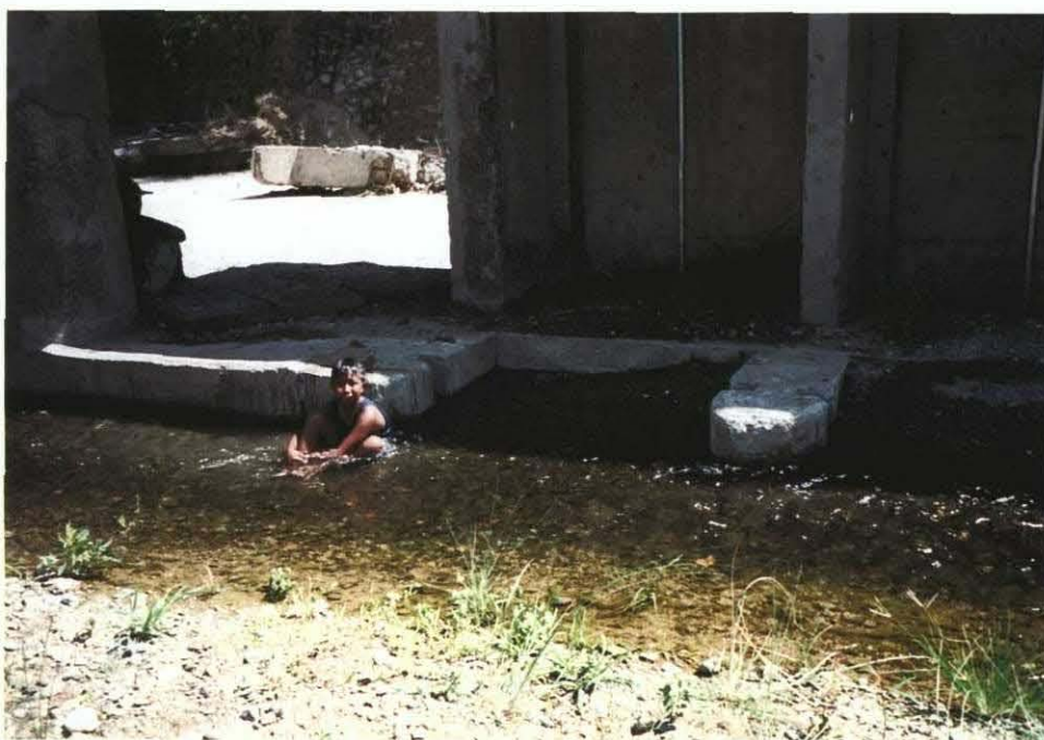
土砂で埋まってしまった取水口
