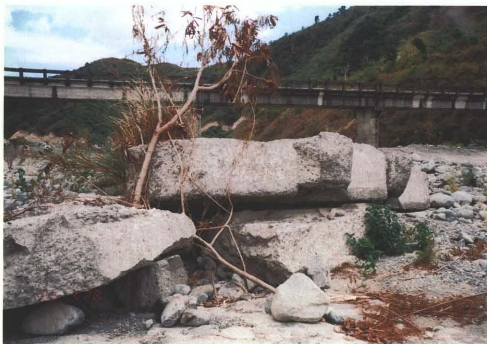
洪水によって崩壊したコンクリート構造物が転がる。
