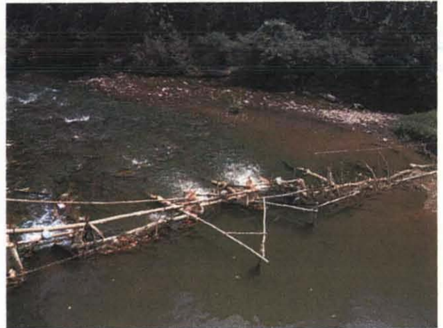
小水力発電器 (Phongxay 郡)
