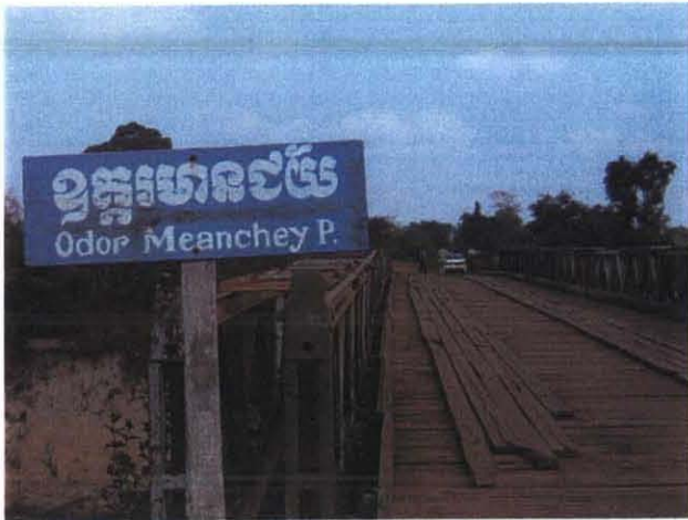
シェムリアップ州との州境の橋梁 (老朽・損壊橋梁整備が緊急課題)
