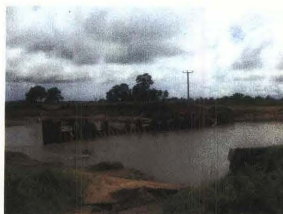
取水堰の被害状況 (アンパラ県) Damaged headworks (Ampara)
