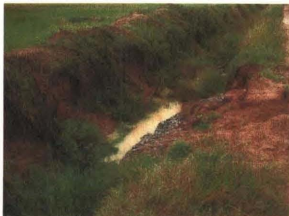
水路の被害状況 (アンパラ県) Damaged irrigation canal (Ampara)
