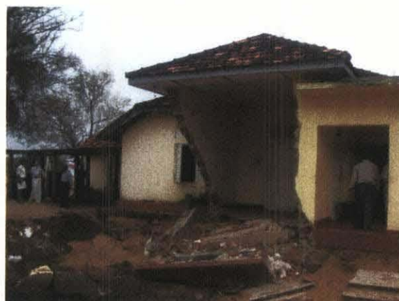
灌漑事務所の被害状況（アナンパル県）
