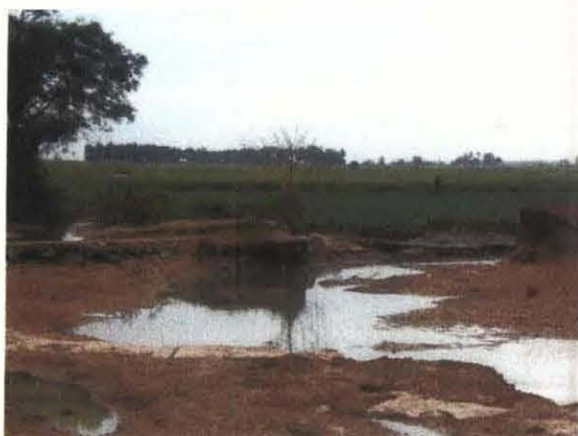
貯水池堤防の被害状況 (アンパラ県) Breached tank bund (Ampara)
