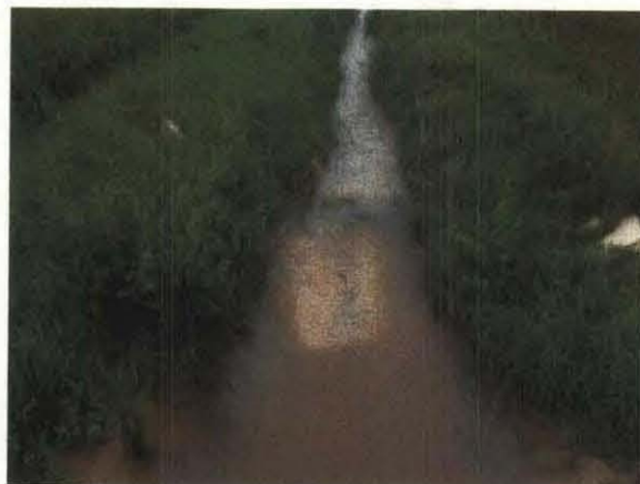
排水路の土砂堆積状況 (アンパラ県) Sand sedimentation in drains (Ampara)
