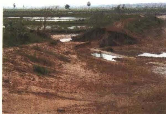
決壊した洪水防御堤 (アムパラ県) Breached flood bund (Ampara)
