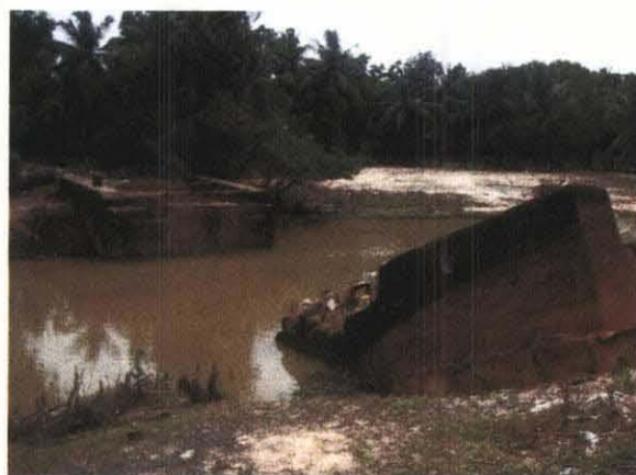
排水路橋梁の破壊（アナンパル県）
