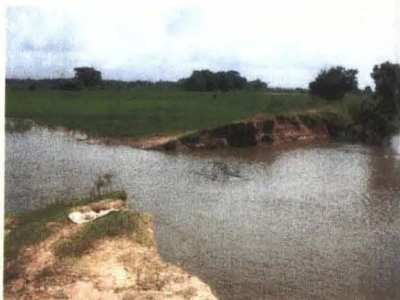
決壊した洪水防御堤 (トリンコムレ県) Breached flood bund (Trincomalee)
