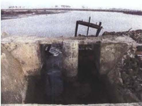
末端放流工の被害状況
