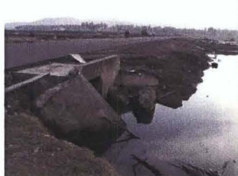
暗渠の被害状況。右は元水田。
