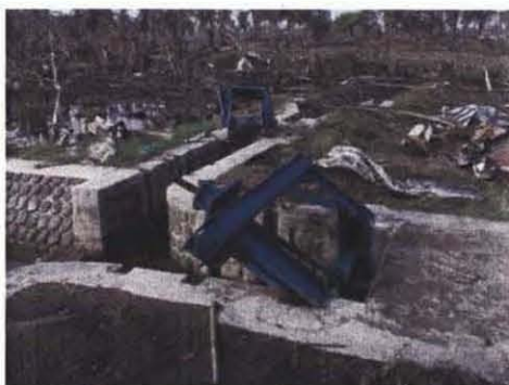
津波により押し曲げられた分水工
