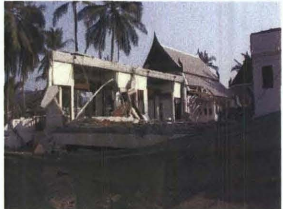
写真—2. 津波により致命的な被害を受けた ホテル
