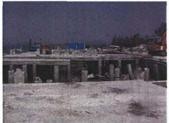
写真—4. 津波により洗い流された船着場
