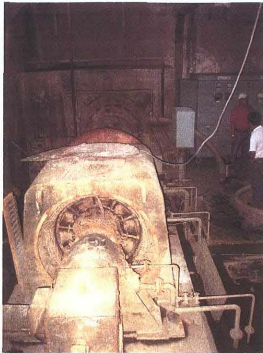
Figure 5. 洪水で冠水し損傷した横軸式発電機。修理不可能で、交換が必要。奥に見えるのは同じく横軸式タービン。
