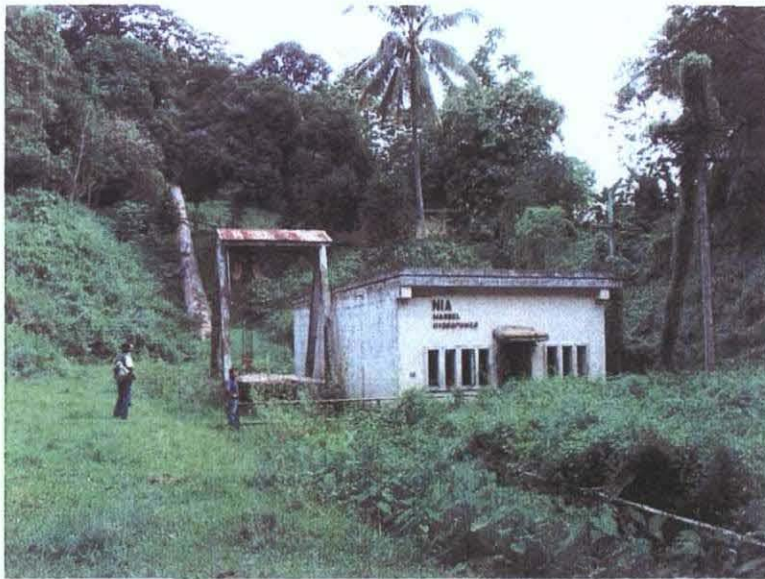
Figure 1. 幹線水路急流部の発電設備棟と導水管(Φ1200)。建物とパイプは、メンテナンスを要するが、使用可能である。建物の左、導水管下流、門型クレーン下部(地下)に横軸のタービンと発電機がある。建物内には配電盤等の設備がある。
