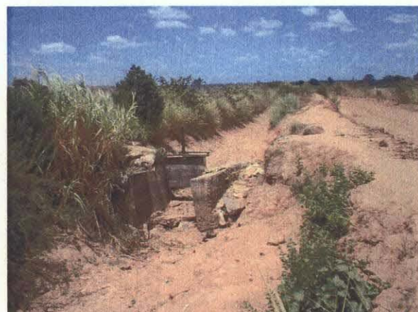
Caxito 市 老朽化した灌漑システム
