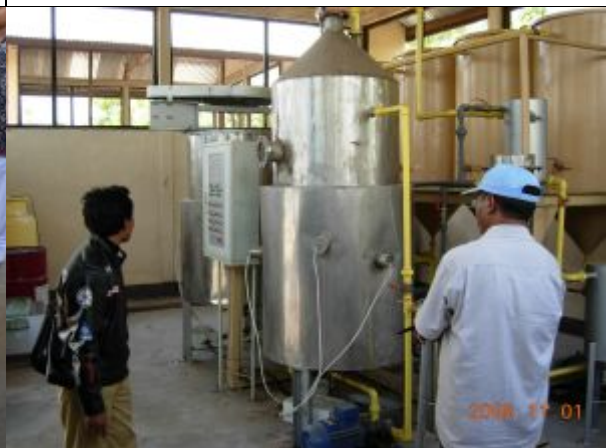
搾油したジャトロハ原油の不純物を分離するプラント。分離過程は 70℃に加熱して水と油を分離してからフィルターで不純物を濾す工程。
