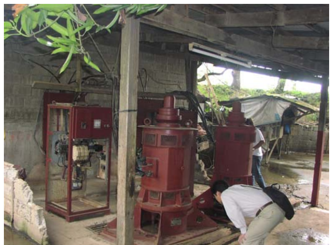
日本製の 2 台の電動ポンプは 1971 年に導入
