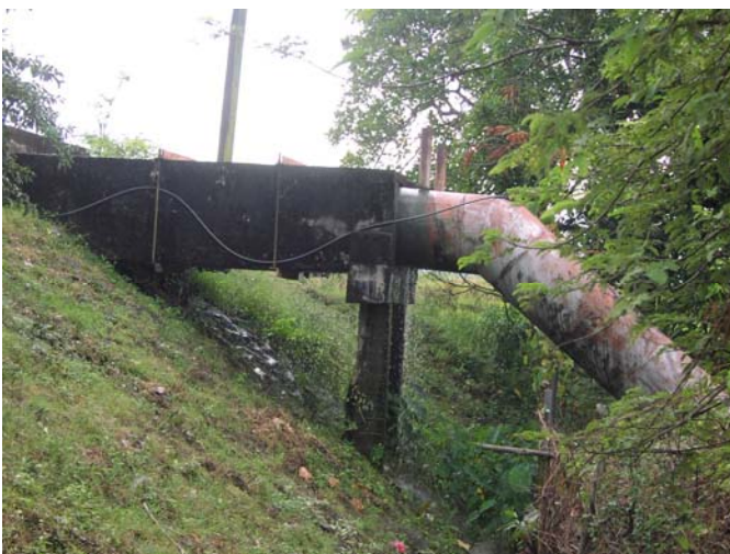
標高の高い圃場への揚水、漏水が目立つ
