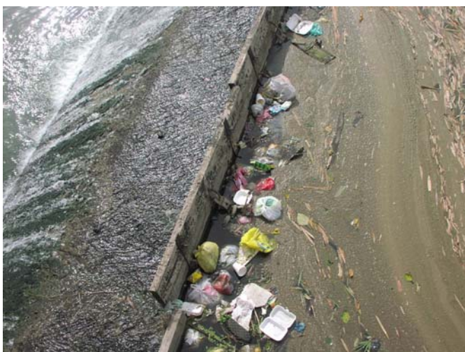
幹線水路にはゴミが多く、異臭がする
