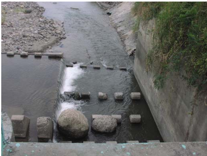
土砂吐には岩が転がり、下流河岸は崩れている
